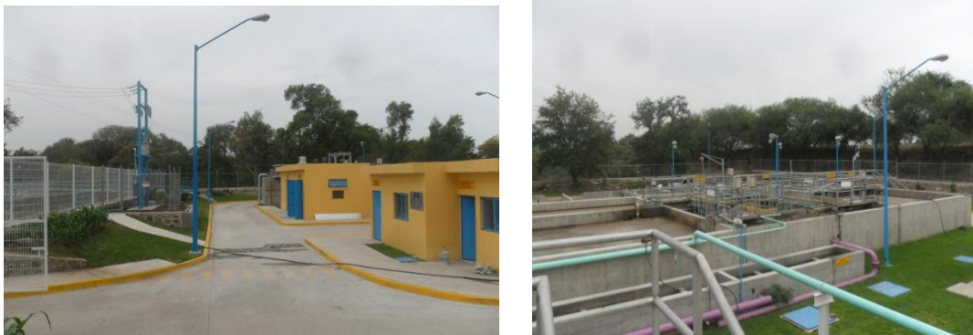
Fig.31 Planta de tratamiento de aguas residuales.
