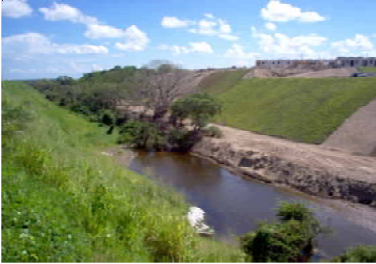
Río Medio, nótese la reducción del ancho del cauce por la terraza construida con arenas producto de la excavación.
