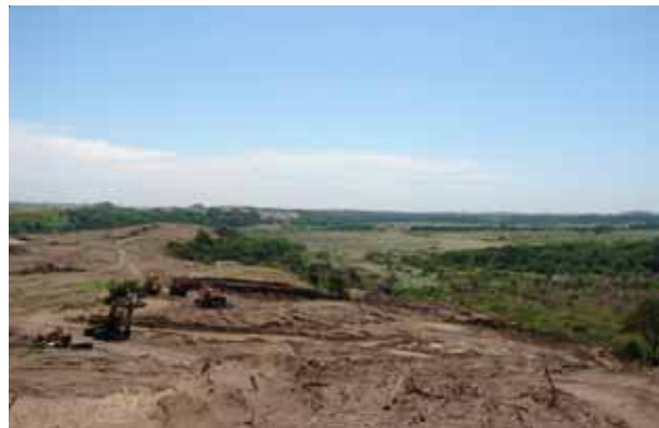
Toma realizada a los trabajos de construcción de una unidad habitacional ubicada al oeste del Río Grande en donde se observa como los movimientos de tierra son revertidos al vaso regulador de la comunidad de Villarín. Fotografía tomada por la empresa consultora Fénix Consultores en Ingeniería S.A. de C. V .
